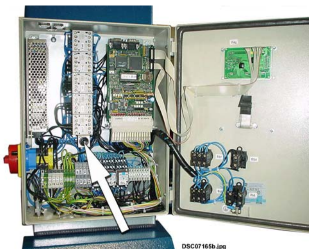
Bild 2: Position des Überbrückungsschalter
